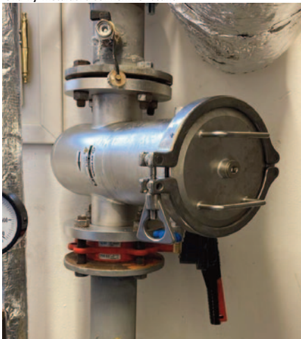
Ukázky instalací a servisního zásahu
