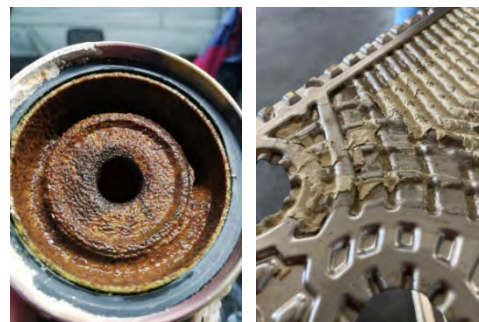
Usazeniny na oběhovém čerpadle a deskovém výměníku
