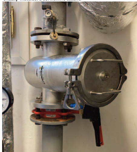
Ukázky instalací a servisního zásahu
