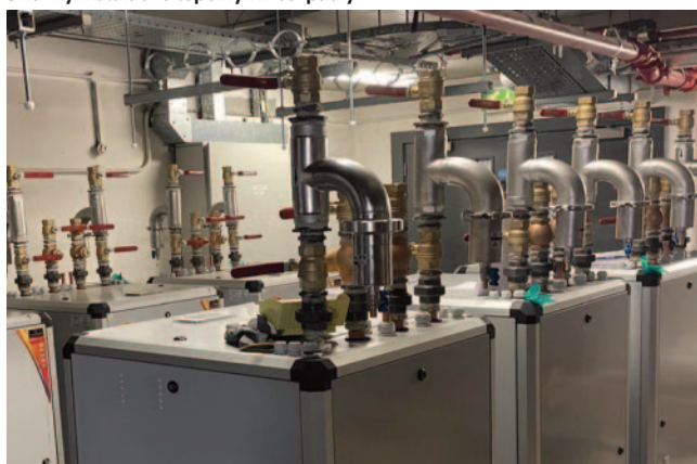
Ukázky instalací s tepelnými čerpadly
